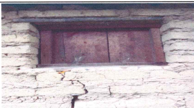
Foto 3: Sustrucción de ventanas de madera por metal mas vidrio
